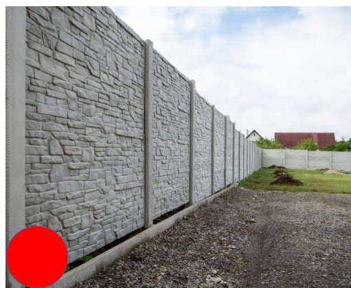
Plot z betonových panelů, příliš vysoký
