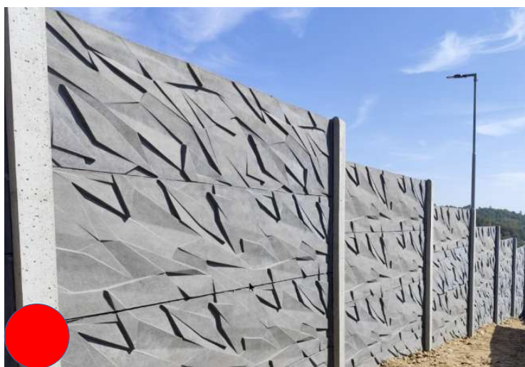
Plot z betonových panelů, příliš vysoký
